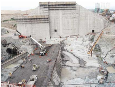
Central Hidroeléctrica Angostura, VIII Región
