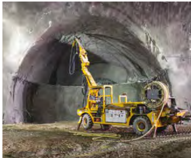
OBRAS CIVILES DE PIQUES, GALERÍAS Y TÚNELES DE TRAMOS 2 Y 3 NORTE DE LÍNEA 3 DE METRO DE SANTIAGO – CHILE
