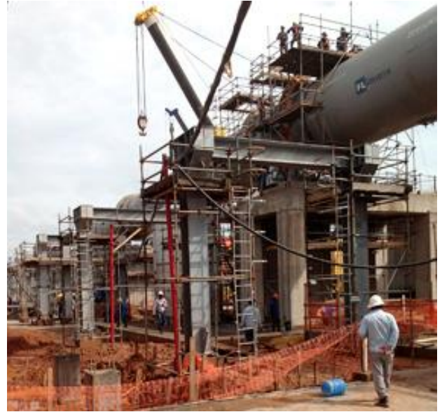
Horno de Cal, planta de caustificación y Patio de Maderas, Planta Suzano Paper - Brasil
