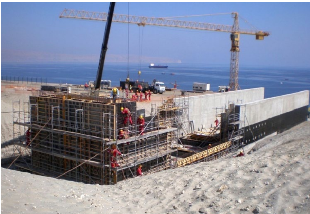
▀ Terminal GNL Mejillones
