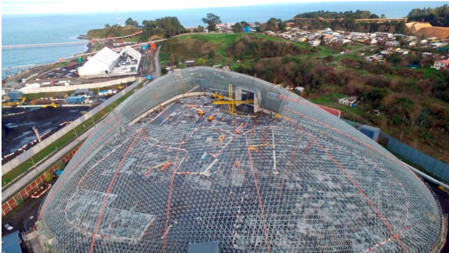
Obras civiles y montaje Domo geodésico techado de canchas de carbón central Bocamina.
