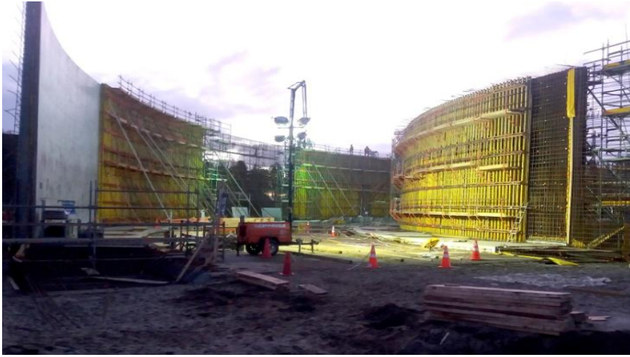
Montaje civil electromecánico planta tratamiento de afluentes de Celulosa Arauco, Planta Horcones.
