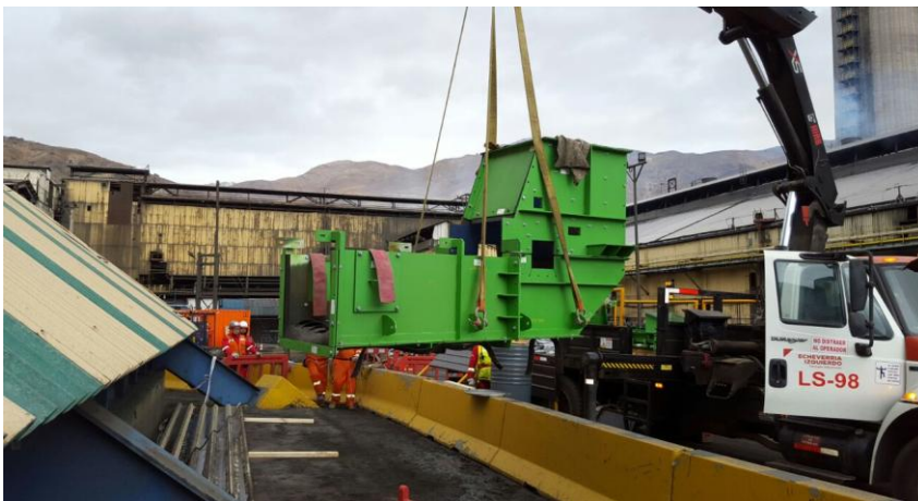
Encerramientos, Equipos de Captura y Filtrado de polvo, Codelco-Fundición Caletones
